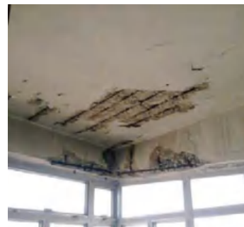
圖 II.19 五街、十三街樓宇失修的情況嚴重，有建築物的石屎剝落，鋼根外露
