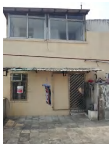
圖 II. 23 在十三街，有僭建的天台屋上再加建多一層建築
