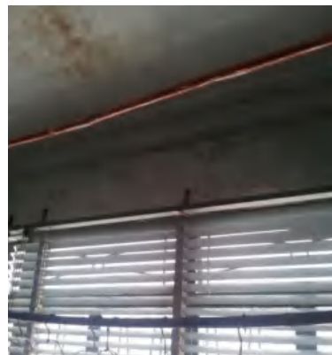
圖 II. 25 有樓宇的天井日久失修，天花的污水渠出現滲漏的問題
